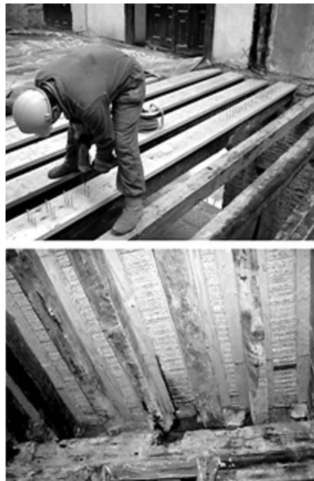
Figura 8. Cuando el peso del hormigón es un inconveniente a la hora de realizar un refuerzo de vigas de madera, se puede recurrir a la madera microlaminada. Al no ser necesario cuajar toda la superficie del forjado, como en el caso del hormigón, el sobrepeso que representa el refuerzo apenas rebasa los 15 kg/m 2 . Para colocar el pavimento en este caso se tendió una capa de mortero sobre un nervacero que salvaba los huecos existentes. (Rehabilitación del palacio Pimentel de Valladolid)
